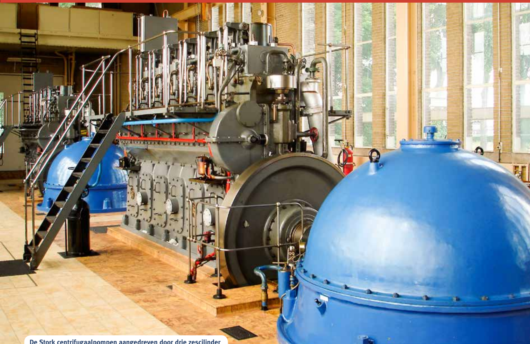
De Stork centrifugaalpompen aangedreven door drie zescilinder Werkspoor Dieselmotoren uit 1936 hebben dienst gedaan tot 2013.
